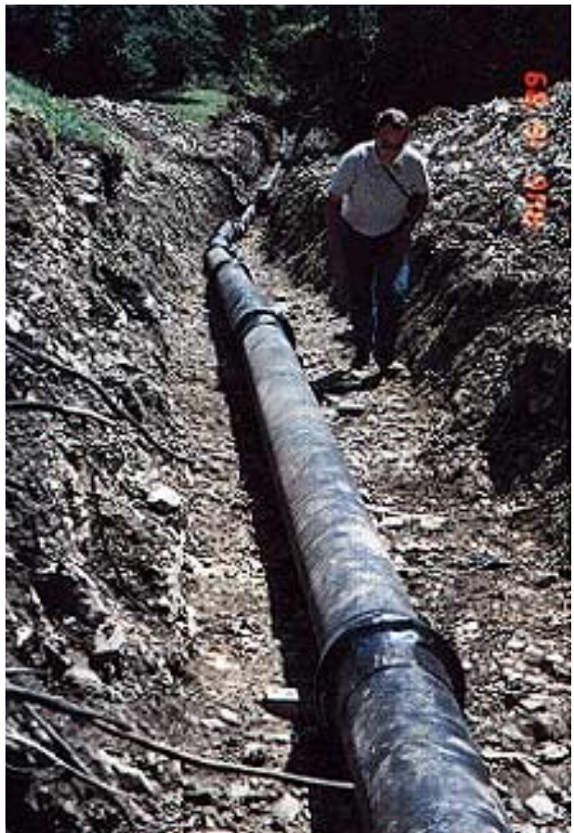
Illustration 2.8 – Conduite forcée en fonte à emboîtements autobloquants en fouille alimentant la microcentrale de la commune de Brienzwiler
