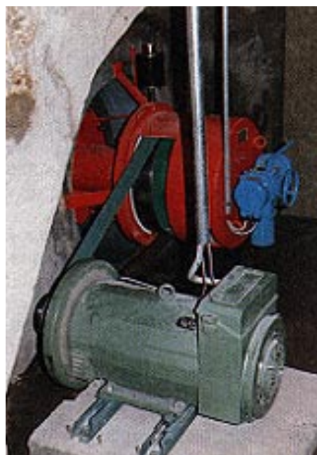
Illustration 4.2 b) – Turbine avec générateur synchrone en exploitation
