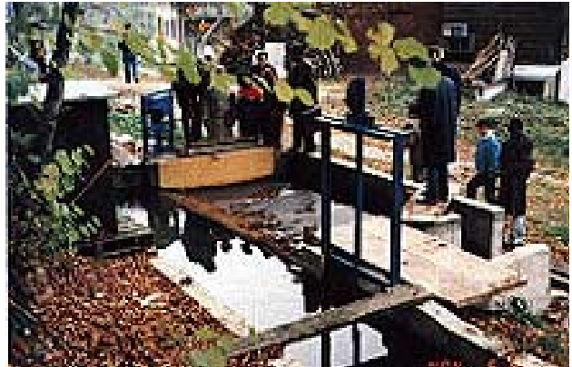
Illustration 2.7 – Dégrilleur autonettoyant à prise tyrolienne de la petite centrale du Moulin de Bavois (VD)
