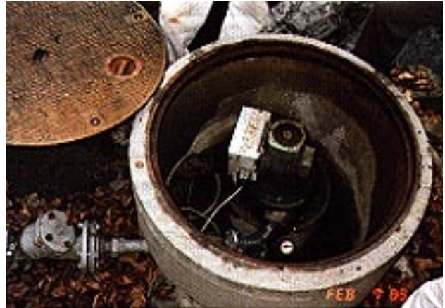
Illustration 7.1 – Microturbine de 250 W installée par un particulier à proximité de Lausanne pour la charge de batteries
