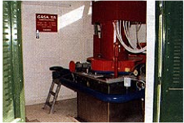
Illustration 4.8 b) – Turbine avec générateur
