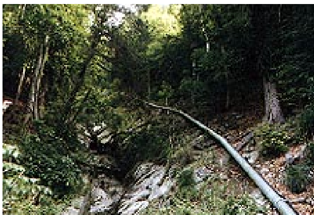
Illustration 4.7 – Conduite forcée en acier, installée en surface dans un terrain escarpé et rocheux
