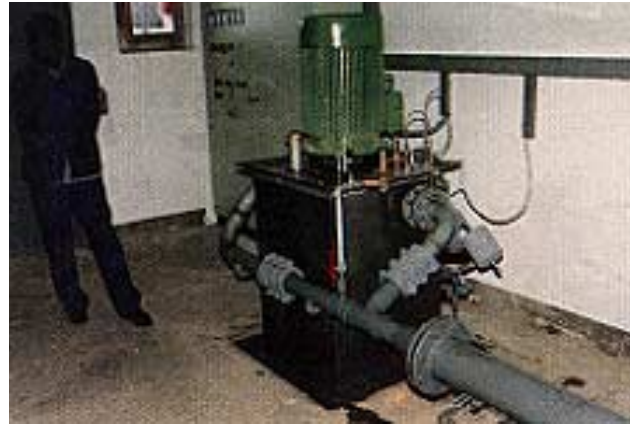
Illustration 2.14 – Groupe turbine-générateur avec son armoire électrique installés après coup dans un local de service du réseau d'eau potable, commune d'Ormont-Dessous, (VD)
