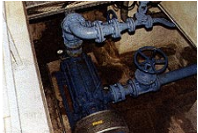
Illustration 7.4 – Pompe inversée fonctionnant comme turbine, avec vanne by-pass automatique, dans l'adduction d'eau de la commune de Boudry (NE)
